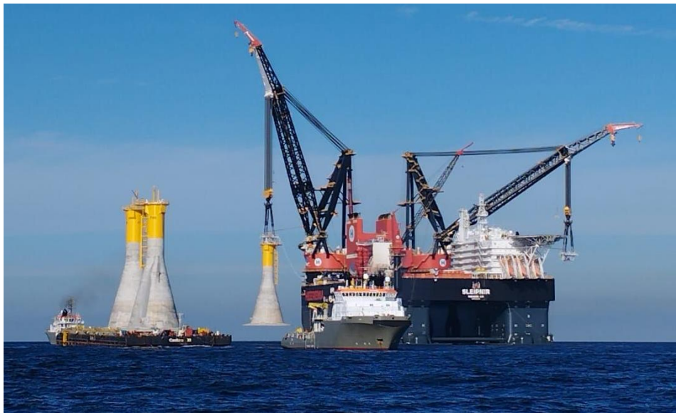
Figure 1-13: Installation des fondations gravitaires sur le parc éolien de Fécamp [Project Cargo Journal, 2022]
